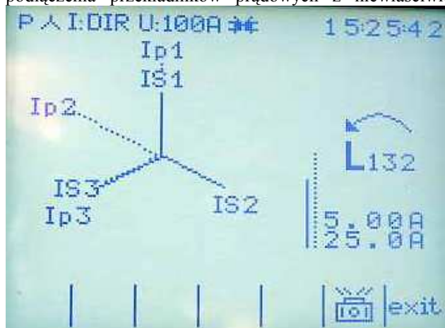
Rys. 5. Wykres wskazowy z niewłaściwym podłączeniem uzwojenia pierwotnego I_{p2}
